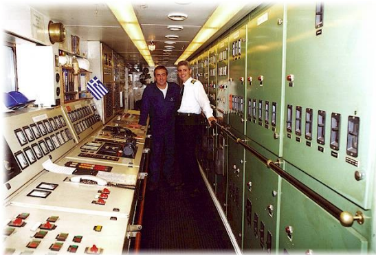
Fig. 1.44 Sala de control
